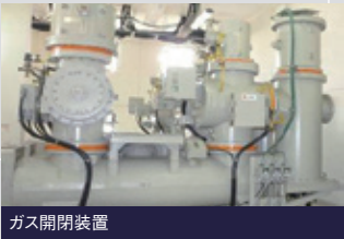
ガス開閉装置
