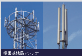
携帯基地局アンテナ
